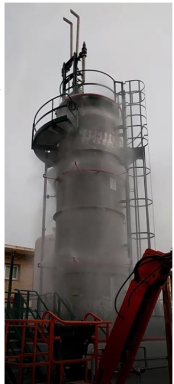
Prueba de anillos de refrigeración
